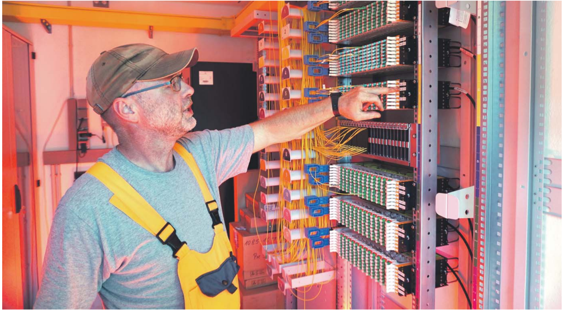
Dieser Schaltschrank ist das Herz des Jevenstedter Glasfaser-Internets. Techniker Waldemar Schwab prüft die Leitungen in dem Container, der die Größe einer Garage hat. 42 Gemeinden mit 22000 Haushalten im ländlichen Gebiet sollen bis 2018 ans schnelle Internet angeschlossen werden. FOTO: WALDEMAR SCHWAB
